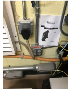
Receptacle on EM – MDF Room
